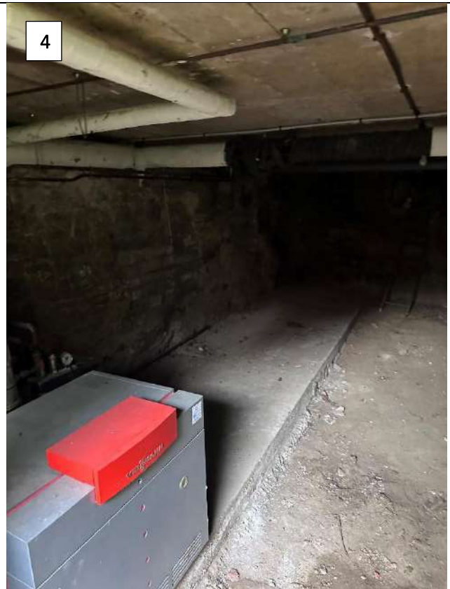
Chaudière et ancienne cuve à fioul
