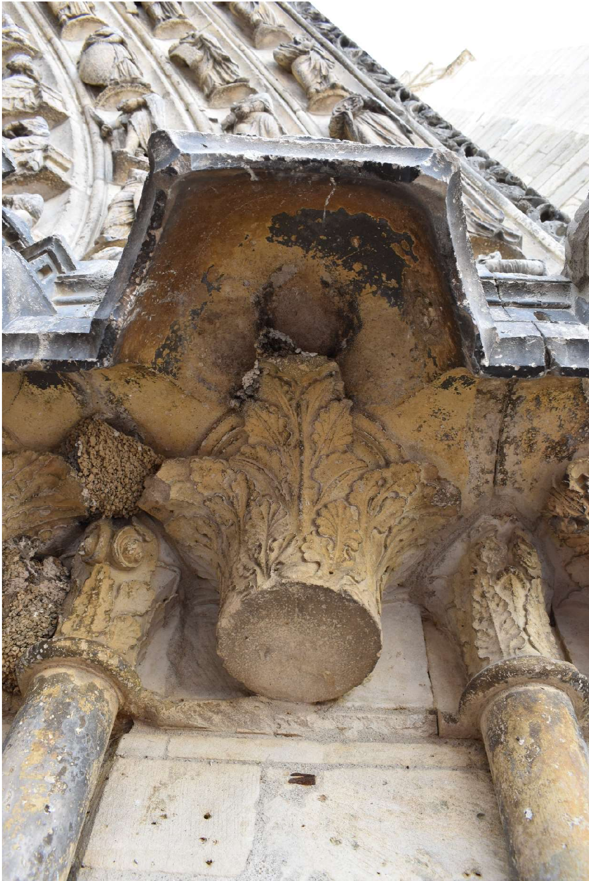
Décor peint altéré à l'endroit d'un nid détruit. Autres nids construits contre les précieux chapiteaux des ébrasements.
