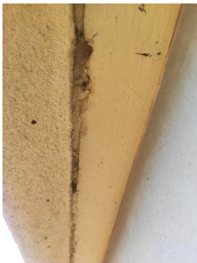
Illustration 3 : Disjointement au-dessus d'une fenêtre non favorable, bouché par du béton
