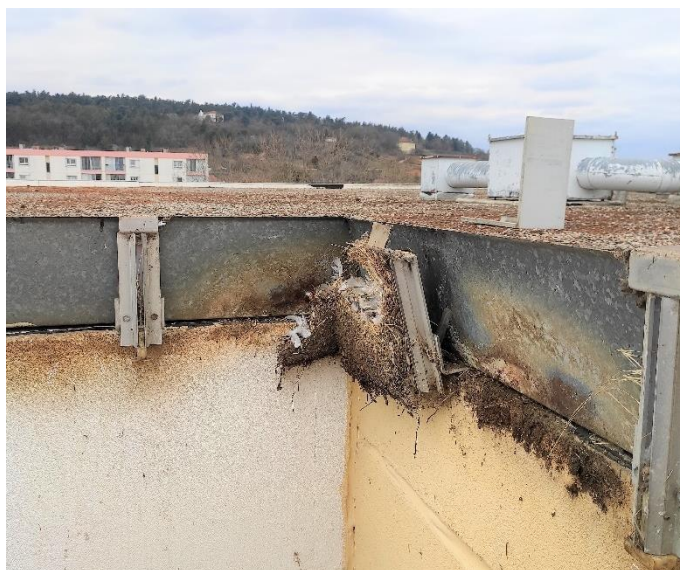
Illustration 5 : Reste de matériel de nidification derrière la couverture du toit
