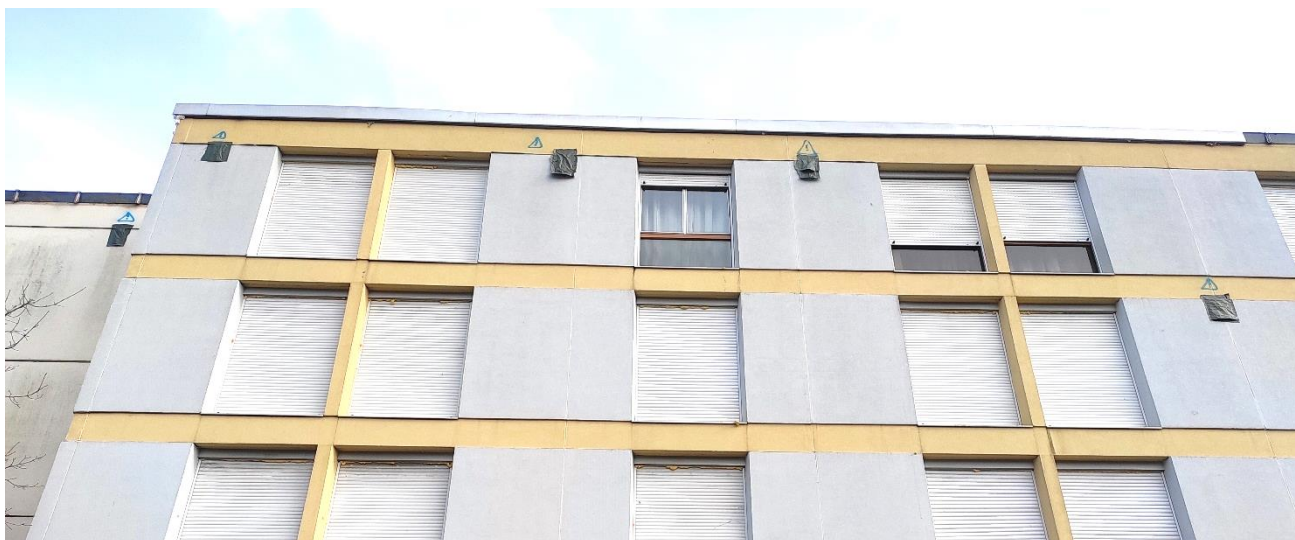
Illustration 8 : Dispositifs anti-retour pour Chiroptères installés à l'entrée N°30 sur la façade ouest
