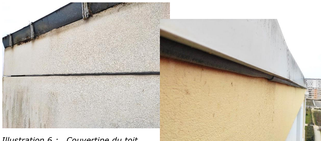
Illustration 6 : Couverture du toit enlevée (à gauche) ou condamnée par des manchons de polyéthylène (à droite)
