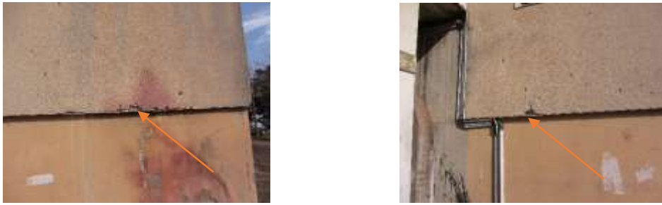
Photos 6: Enduit dégradé.
