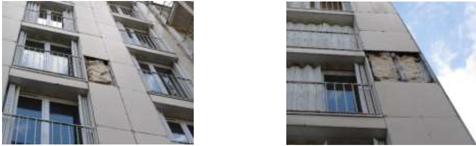
Photos 9: Plaques manquantes.
