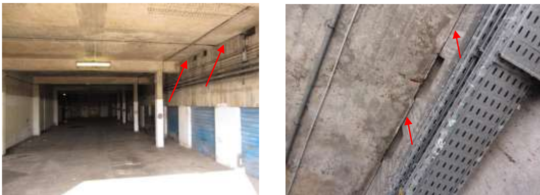
Photos 10: Joint de dilatation entre mur et plafond pouvant être utilisé comme gîte par les chiroptères.
