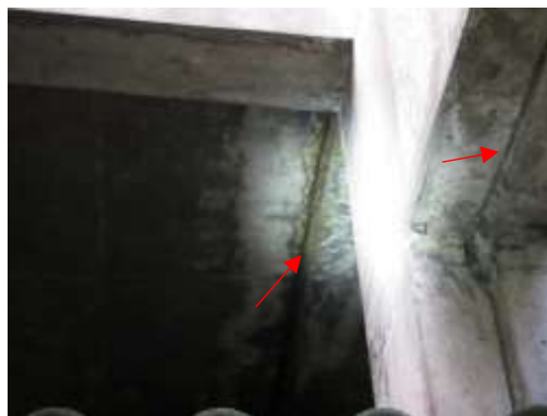
Photo 11 : Joint de dilatation pouvant être utilisé comme gîte par les chiroptères.
