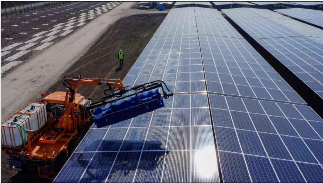
Figure 27 : Exemple de procédé de nettoyage des modules
