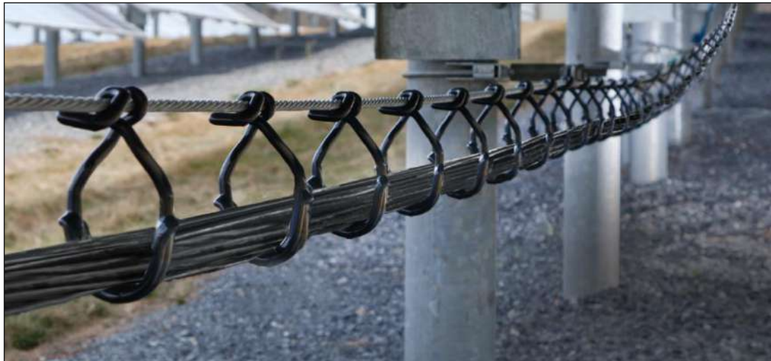
Figure 12 : Exemple de câblage hors-sol (Source: CAB Solar)
