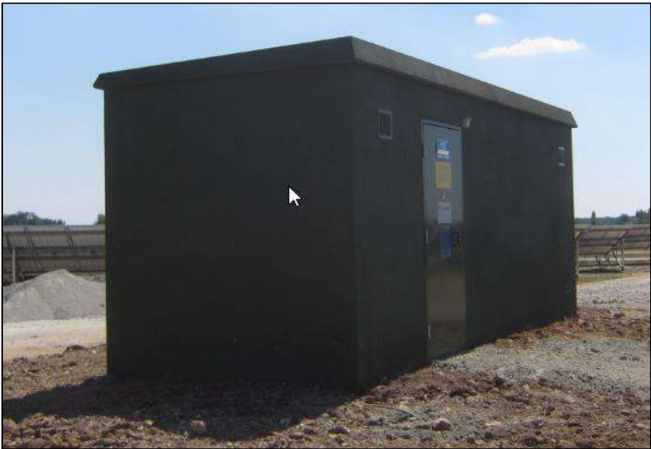
Figure 13 : Exemple de poste de conversion « indoor »
