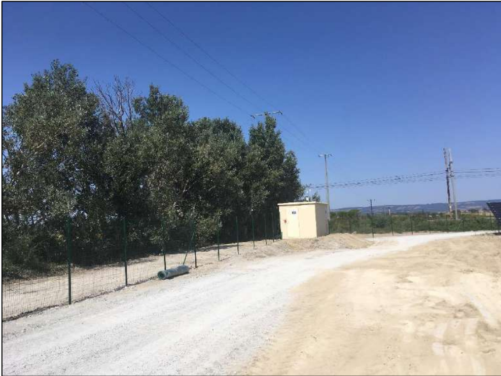
Figure 15 : Exemple de poste de livraison
