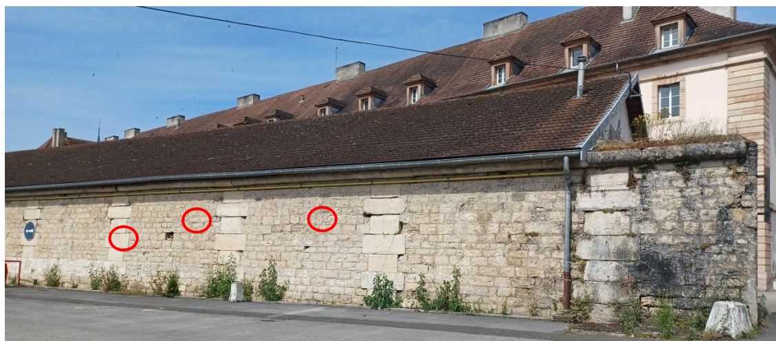
Figure 17: Cavités plus ou moins profondes au niveau de la façade la plus ancienne
