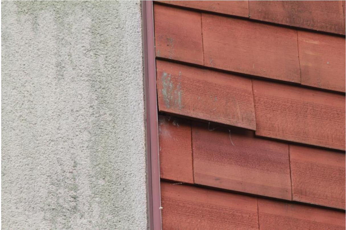
Figure 9 : Exemple de tuile décollée favorable à l'installation de chiroptères
