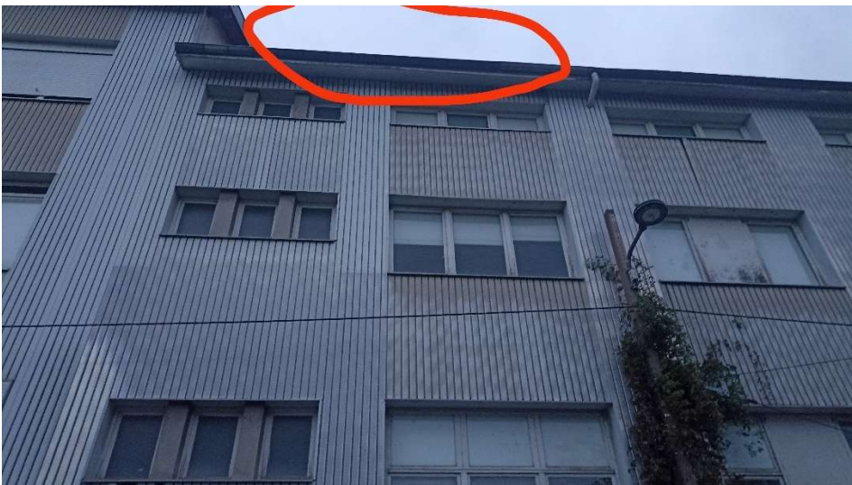
Figure 21 - Chauve-souris sp. aperçue sortant du toit
