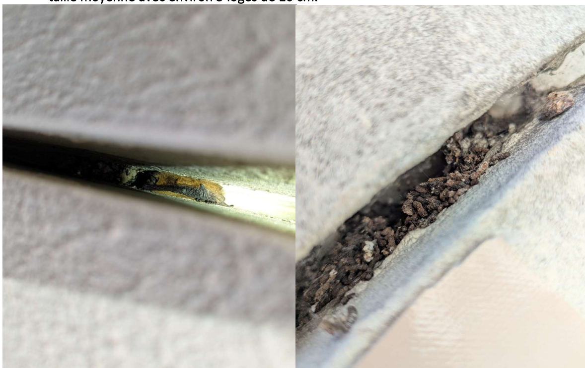
Figure 31 - Image de gauche, pipistrelle sp et image de droite, tas de guanos, les deux découverts lors de travaux de défavorabilisation
