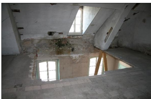
Zone de l'effondrement principal de 2018 dans l'aile sud des combles
