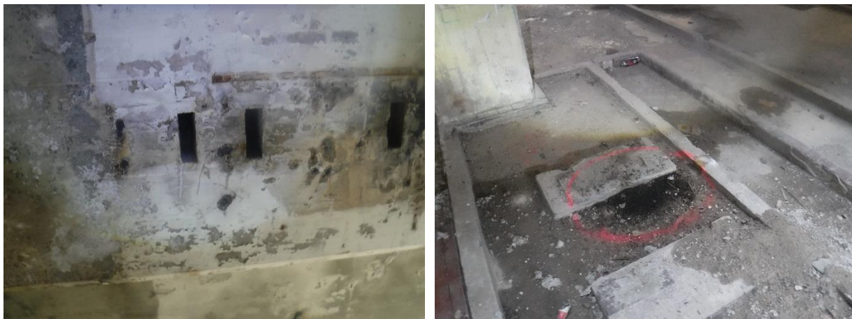
Ouverture dans une poutre béton large favorable aux chiroptères dont le Grand murin et exemple de tas de guano au sol
