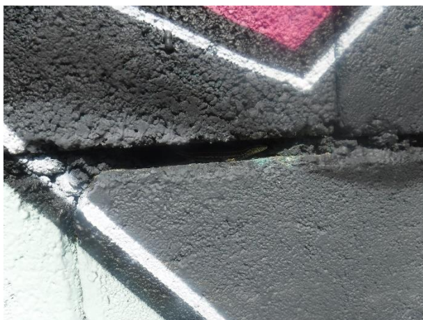
Lézard des murailles dans une fissure entre deux blocs bétons au sud du bâtiment « Cathédrale »
