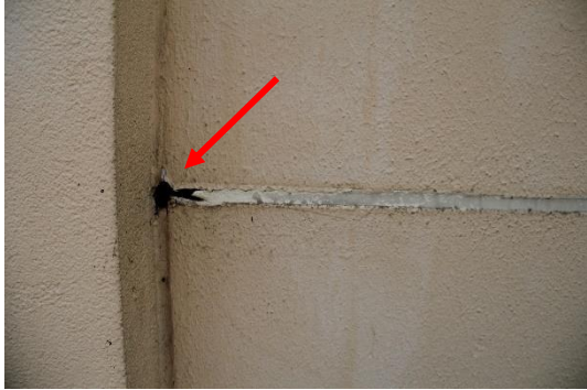
Figure 8 : Défaut de maçonnerie
