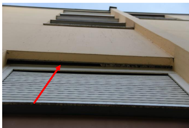
Figure 10 : Espace libre entre le coffrage du volet roulant et la maçonnerie
