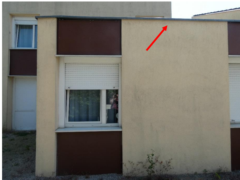
Figure 7 : Espace quasi inexistant entre la couvertine et la partie supérieure de l'acrotère
