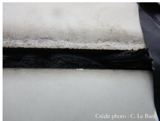
Figure 23 : Exemple de condamnation avec des « boudins » de mousse d'isolation de tuyau de chauffage
