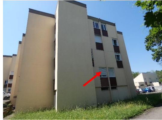
Figure 13 : Un peu de guano entre le coffret de volet roulant et la maçonnerie
