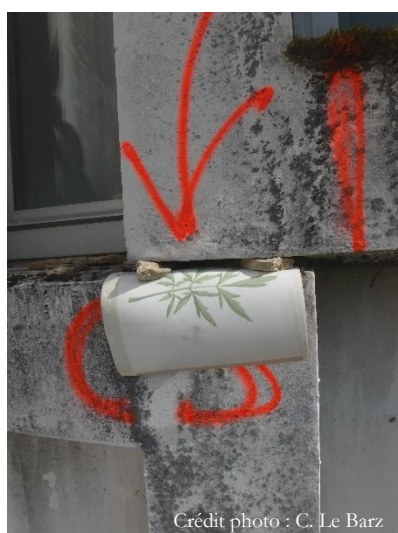
Figure 24 : Exemple de système anti-retour en fissure horizontale
