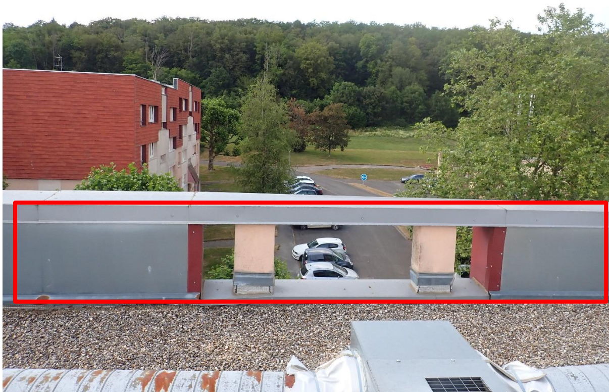
Figure 35 : Acrotère creux permettant l'accueil des nichoirs ou les gîtes artificiels au sein des bâtiments
