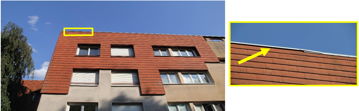
Figure 11 : Espace accessible entre la couverture et le haut de l'acrotère
