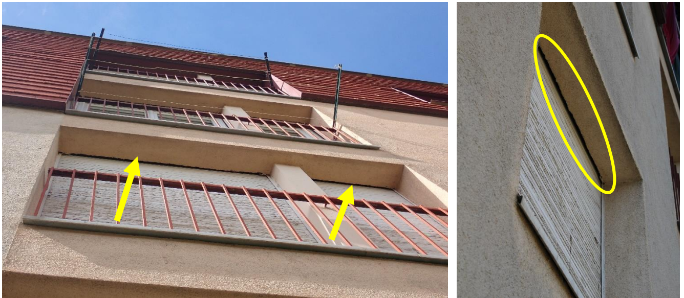
Figure 15 : Espace libre entre le coffrage de volet roulant en bois et la maçonnerie
