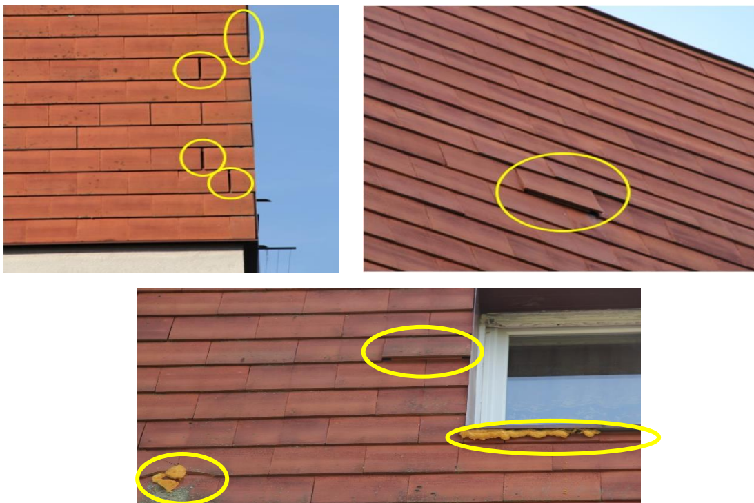
Figure 16 : Disjointement entre les tuiles du bardage
