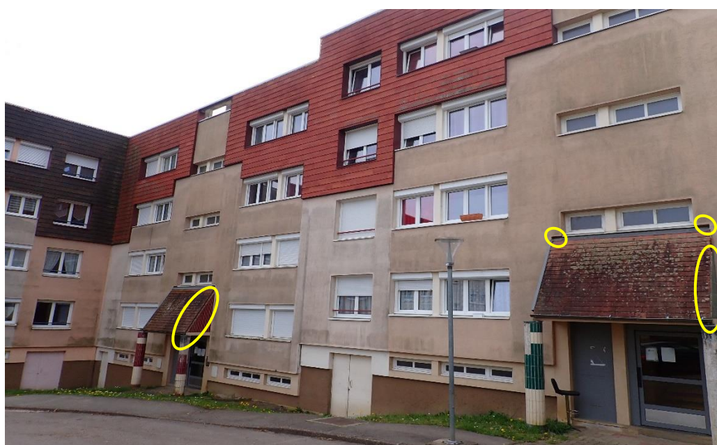
Figure 18 : Absence de bordure métallique sur le toit des entrées couvertes
