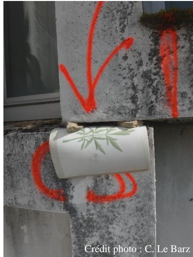
Figure 32 : Exemple de système anti-retour en fissure horizontale
