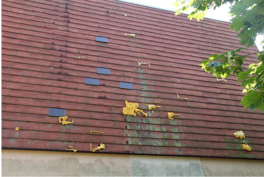
Figure 13 : Défaut d'habillage, isolation
