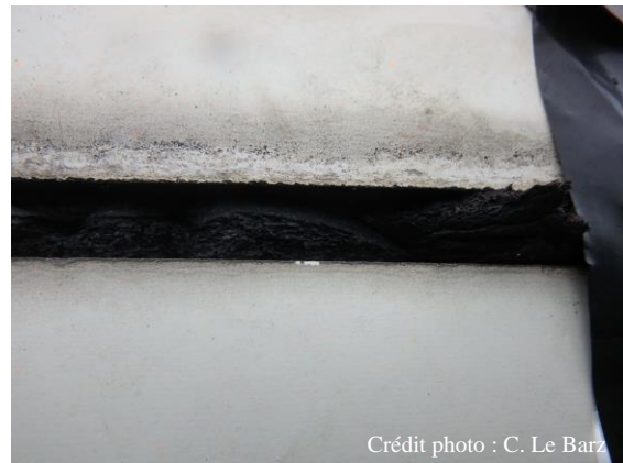
Figure 31 : Exemple de condamnation avec des « boudin » de mousse d'isolation de tuyau de chauffage
