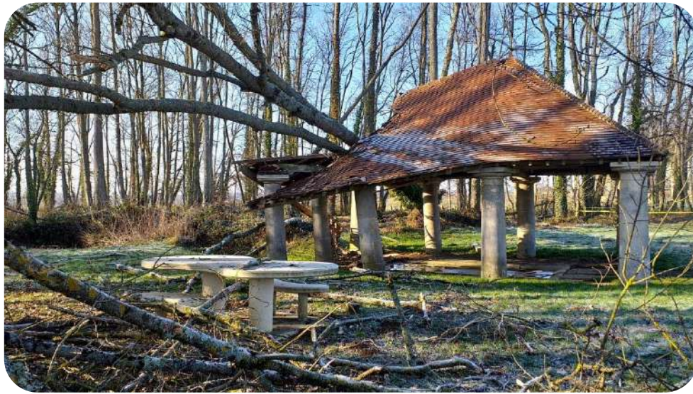
Photo 3 : Dégâts causés par la chute d'un frêne (nuit du 8 au 9 janvier 2022) (P. SCHWIRTZ, 2021)
