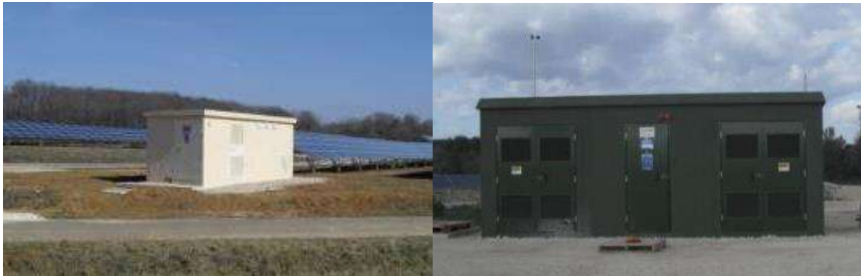
Figure 76 : Poste transformation couleur beige du parc solaire de Sourduin et poste de transformation couleur vert du parc solaire de Pujaut (source : GDS)
