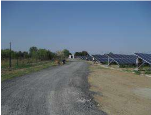
Figure 78 : Route interne et clôture d'une centrale au sol réalisée par GDS
