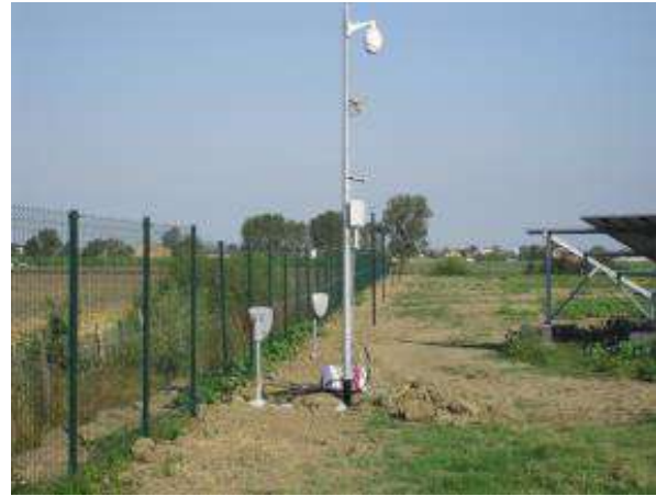
Figure 79 : Système de surveillance par caméras vidéo avec enregistrement numérique, centrale solaire réalisée par GDS
