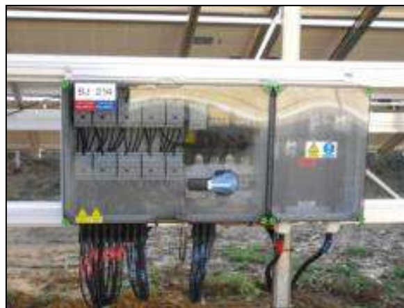
Figure 75 : Exemple de coffrets de regroupement (source : GDS)
