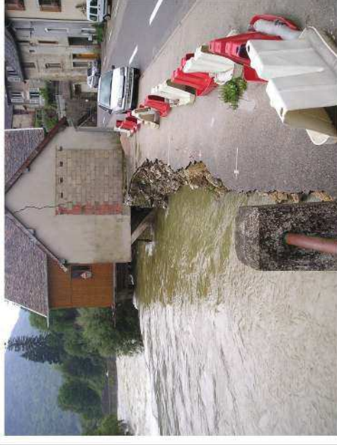
Érosion de berges à Lods (25) 2006 (Source Cerema-DLA)
