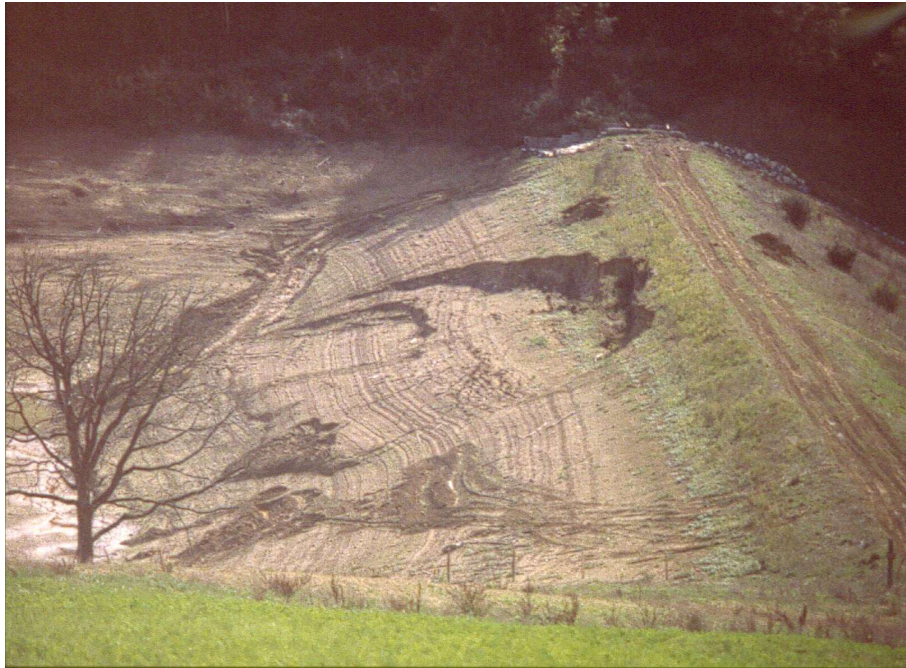
Figure 8 : Glissement de parement amont (Source : Irstea)
