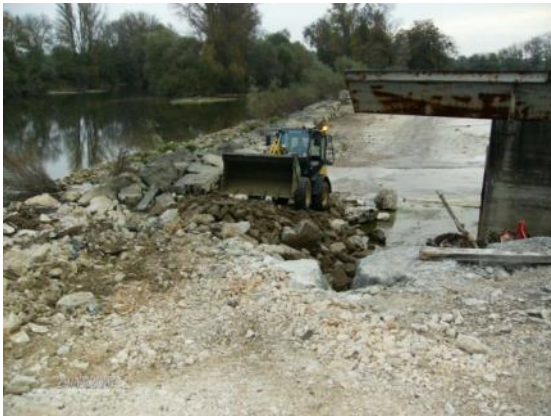
Figure 24 : Réalisation d'une rampe d'accès à l'aval du seuil (photographie issue du rapport de fin de travaux de 2007)
