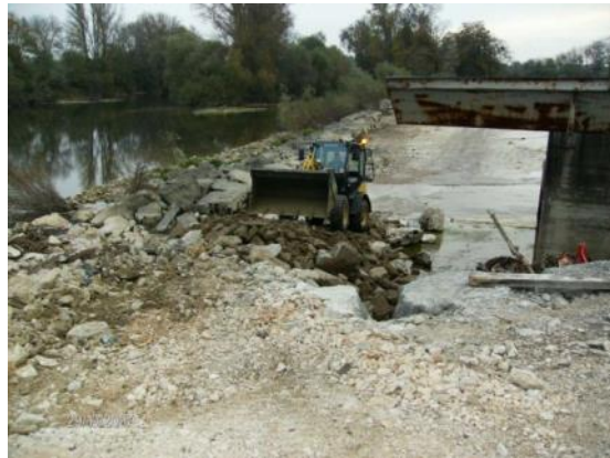
Figure 11. Courte piste possible pour l'accès au seuil aval (en bas, exemple des travaux de 2007)
