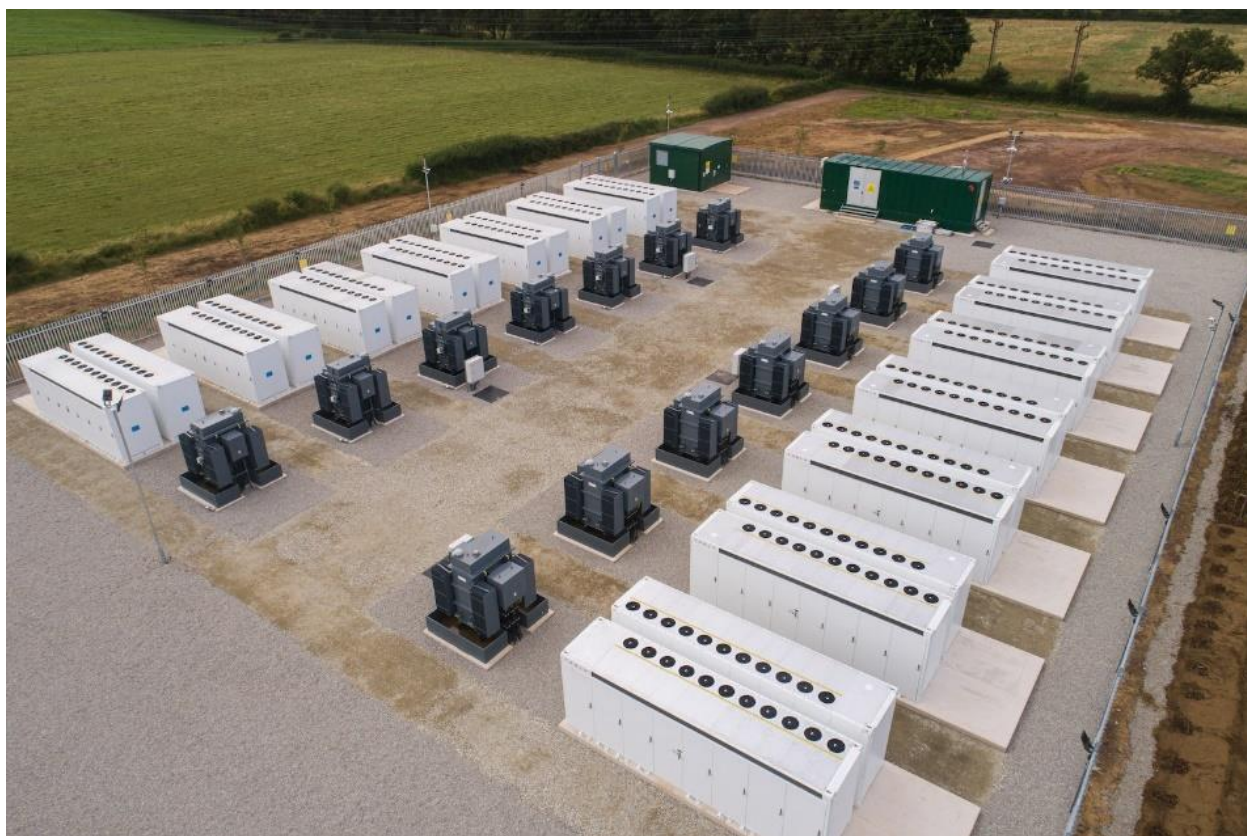
Figure 13 : Vue aérienne de la centrale de stockage de Contego (34 MW / 68 MWh), développée et opérée par Harmony Energy
