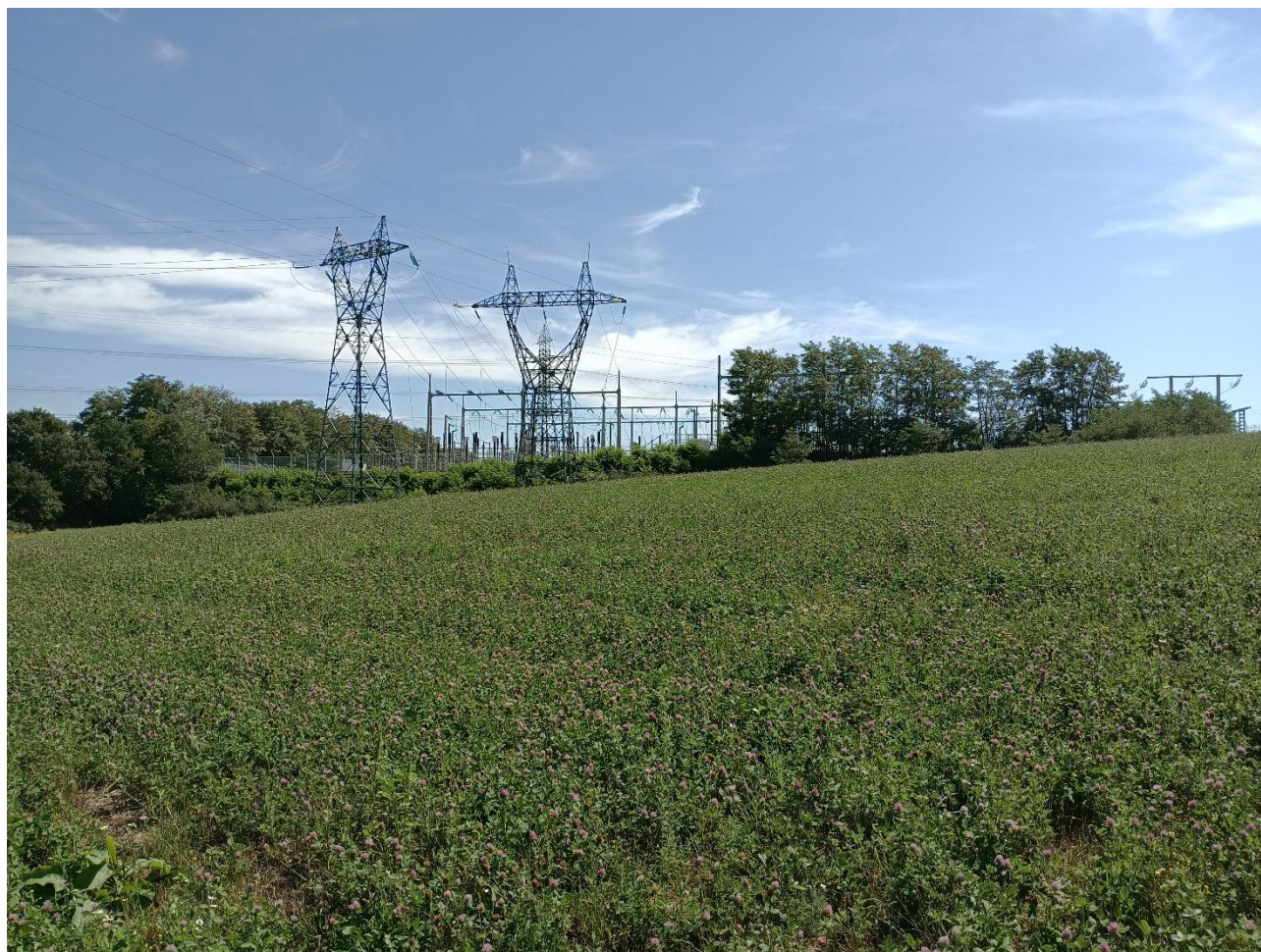
Figure 15 : Le poste électrique de Henri-Paul (photo prise depuis l'ouest du poste)
