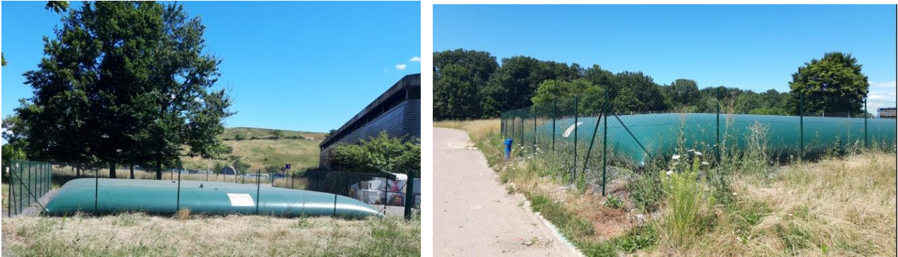
Figure 27 : Vues des 2 bâches incendie (nord et sud)
