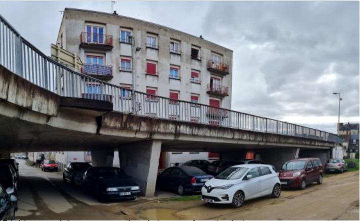
Résidence voisine et occupation de la sous-face du viaduc
