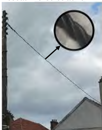
Réseau fils isolés aérien BT
