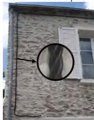
Réseau fils isolés façade BT
