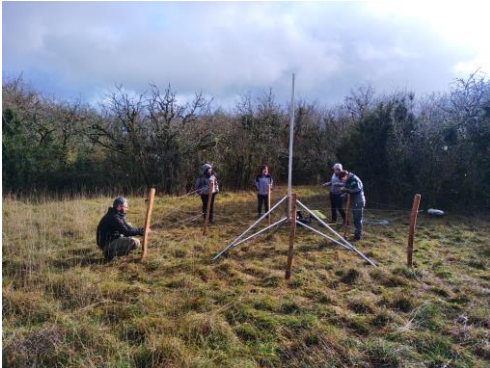
Implantation du mat de la station automatisée Campbell
