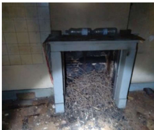
Figure 7 : Indice de présence d'un ancien nid de Choucas des tours dans la cheminée
