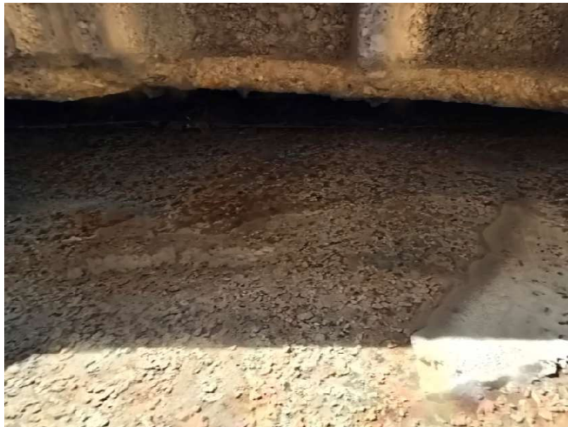
Figure 14: disjointement entre un parpaing et une ancienne porte
