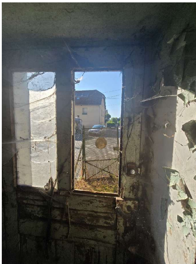
Figure 30 : Ouverture favorable à la pose d'un système anti-retour
