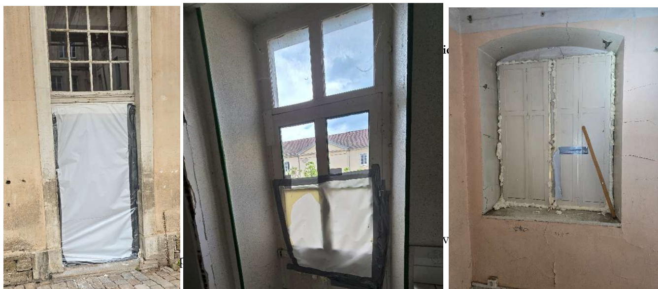
Figure 29 : Exemple de DAHU au niveau des menuiseries
