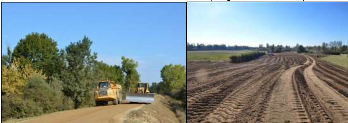
Circulation dangereuse sur la digue
