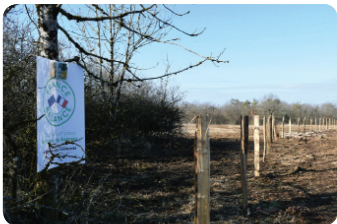
Clôture en cours de réalisation sur la pelouse hors RNN © F. Ravenot
