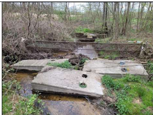
Avant (ouvrage effondré complètement)
