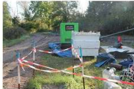
Groupe électrogène et cuve de fioul
