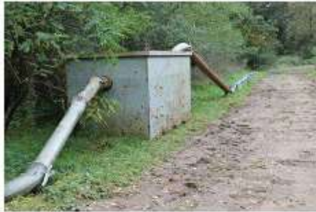
Cuve de décantation
