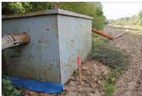
Cuve de décantation
