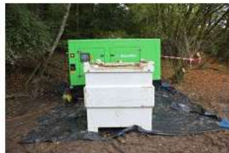
Groupe électrogène et cuve de fioul
