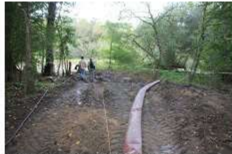
Ornières au niveau du palier supérieur
