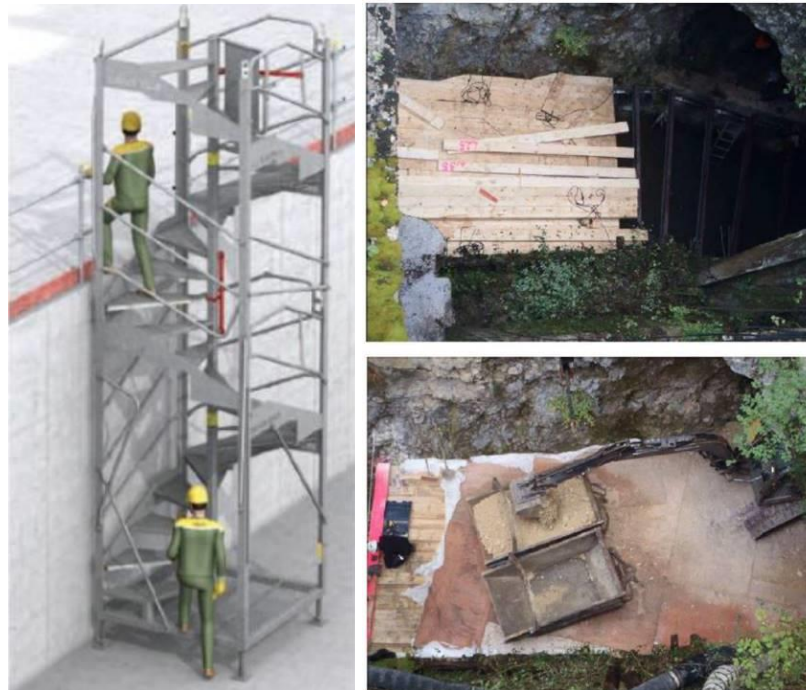
Figure 4 : Illustration d'escalier temporaire (à gauche) ; Exemple de plateforme d'accès à la galerie (à droite)
