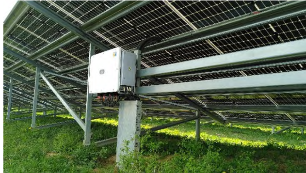
Figure 5-5 : Exemple d'onduleur accroché derrière les tables de modules (source : TSE)
